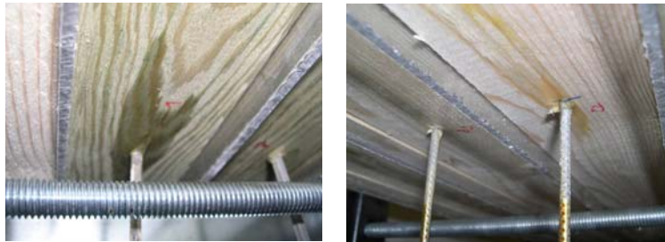
Fuktplekk ved håndspiker i trykkimpregnerert materiale.....maskinspiker i vanlig trevirke
