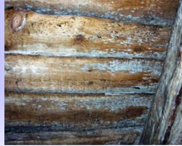
Vekst på undersiden av bordtaket på et uoppvarmet loft
