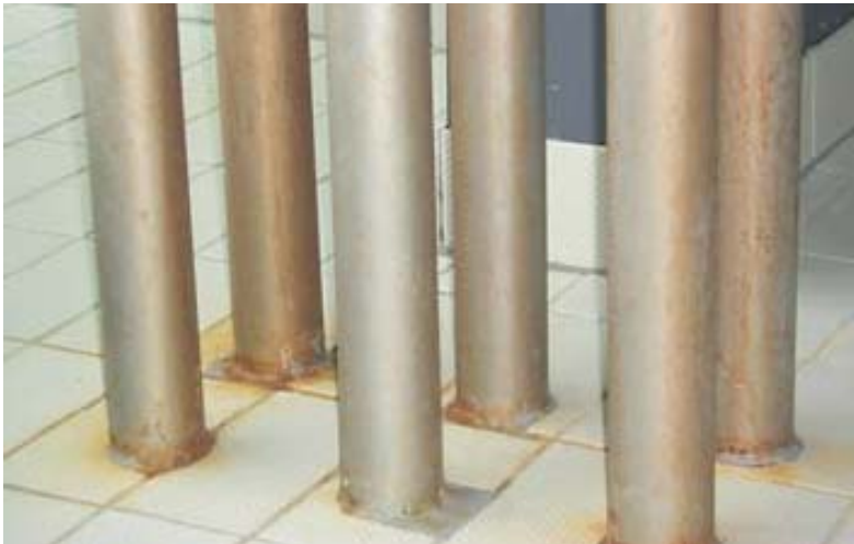
Overflaterust på sveiser med en matt overflate
