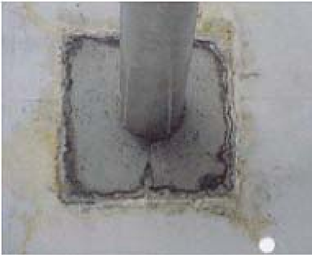
Korrosjon av varmforsinket stål i bade-anlegg.
