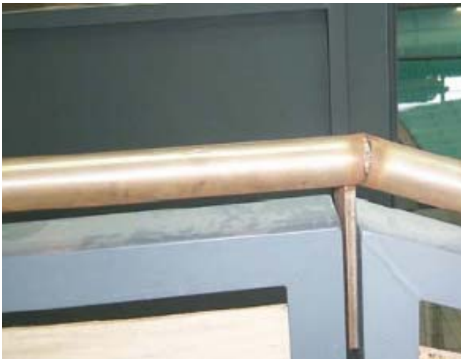
Slørrust/overflate rust på slipt overflate
