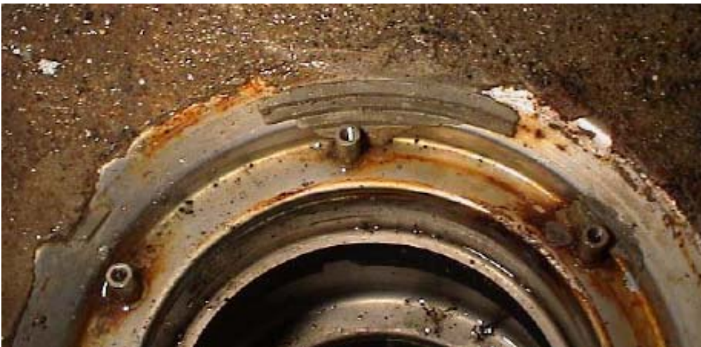
Korrosjon av sluk i spaltene under skrue festene
