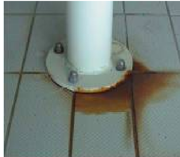
Malt C-stål - Korrosjon fra undersiden av flens umulig å komme til for vedlikehold
