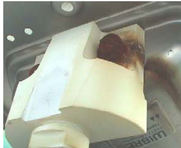
Servant tilkobling der feil materiale er blitt benyttet
